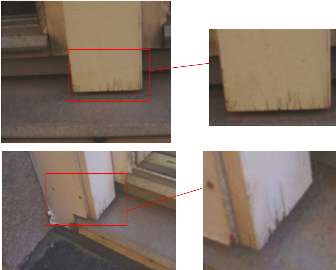
Bild 5 & 6. Anfänger Fenster Schäden auf etwa 15 Jahre alten Fenstern.
