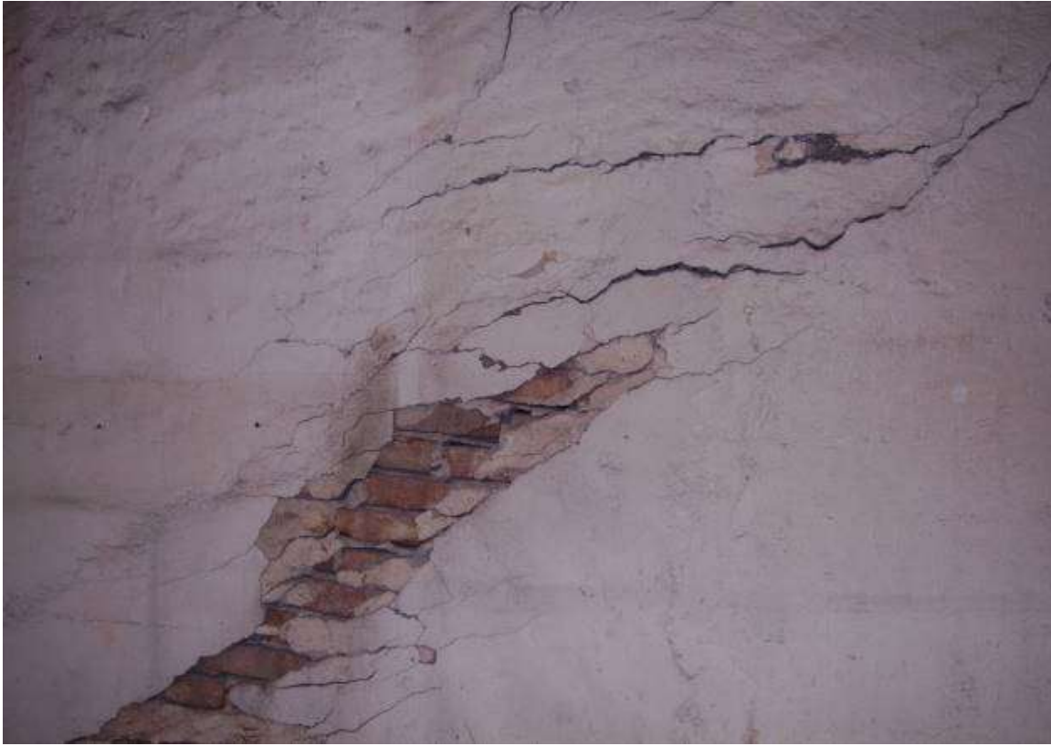
Bild 8. Risse in einer Kellerwand, weil der Boden unter der Mauer gesunken war und die Mauer nicht von Pfählen gestützt wurde. Als wir Löcher in die Wand bohrten, fanden wir, dass es etwa 0,3 Meter zwischen dem Boden und der Unterseite der Wand war. Um die Funktion zu gewährleisten, bauten wir eine Balkenkonstruktion, die auf Stapeln bis zum Grundgestein, außerhalb der Wand ruht. Das Design hat beide halten die Wand aufrecht und übernahm es seine Last unterstützende Funktion.
