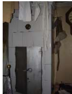
Viele Wohnungen wurden nur mit Keramikherden erwärmt.
