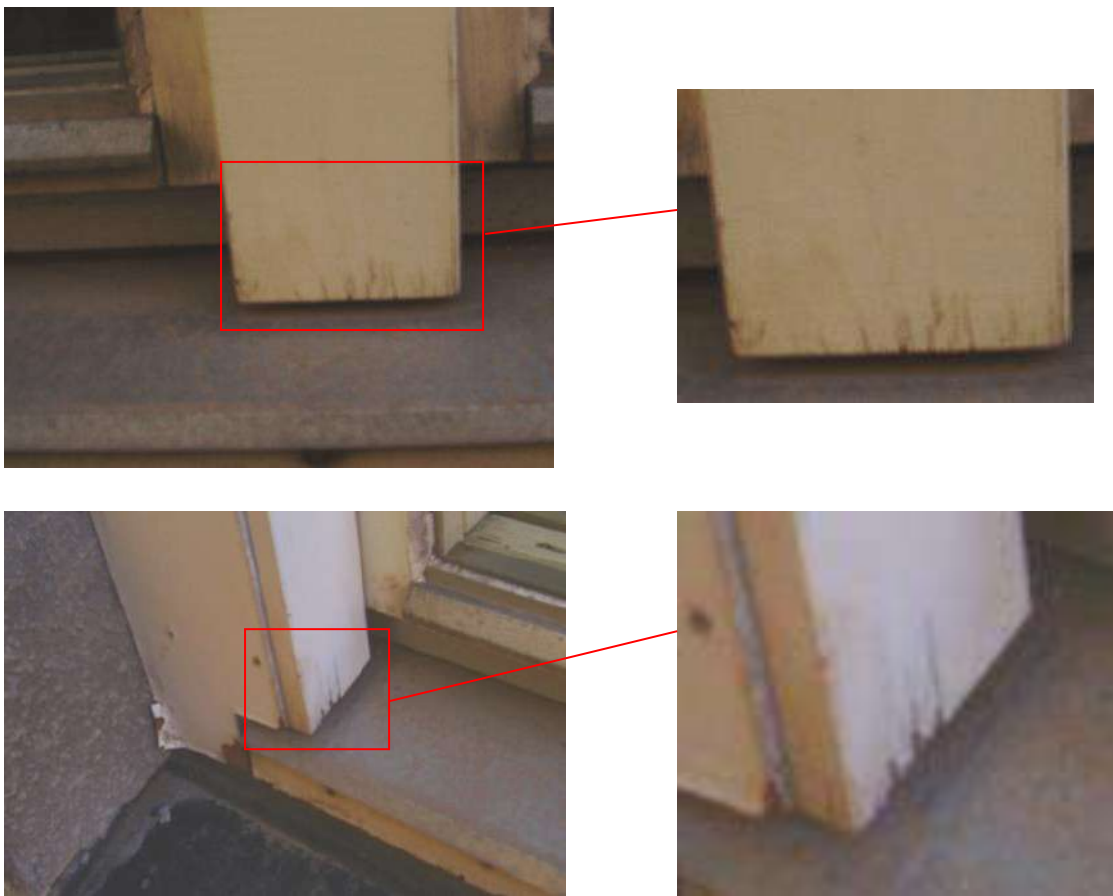
Bild 5 & 6. Begynnande fönsterskador på cirka 15 år gamla fönsterkonstruktioner.
