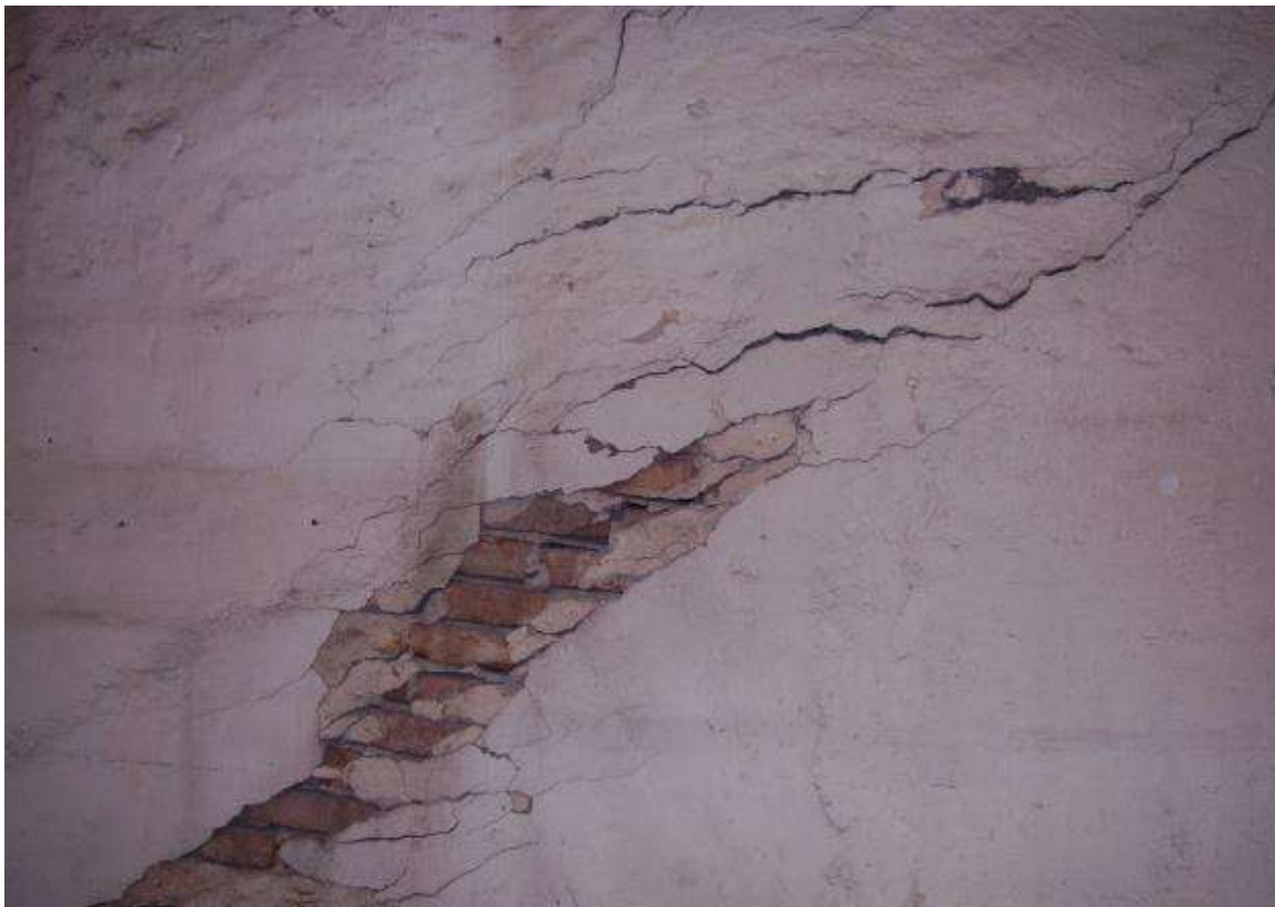
Bild 8. Sprickor i en källarvägg på grund av att marken under väggen har sjunkit och väggen inte är underbyggd med pålar. När vi borrarde hål under väggen kunde vi konstatera att det var cirka 0,3 meter mellan marken och undersidan av väggen. För att säkerställa väggens funktion byggdes en balkkonstruktion, som vilar på pålar ner till berggrunden, framför väggen. Konstruktionen håller dels väggen upprätt och dels bär den det överliggande bjälklaget.
