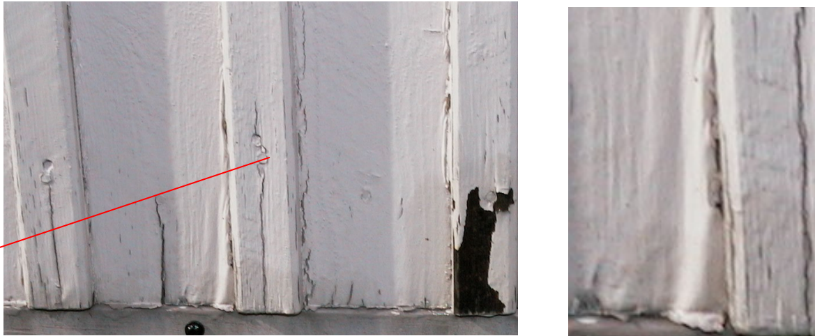
Bild 1. Färg som släppt från fasaden.
