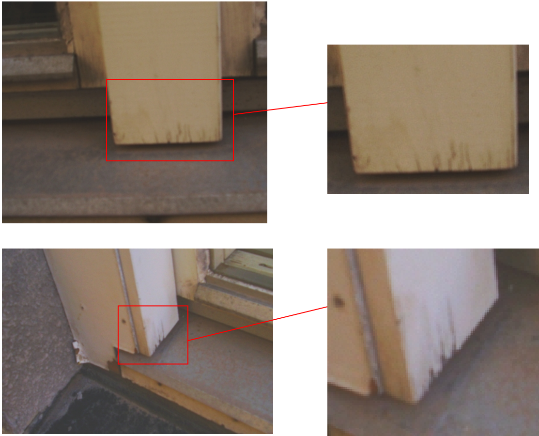
Bild 5 & 6. Begynnande fönsterskador på cirka 15 år gamla fönsterkonstruktioner.
